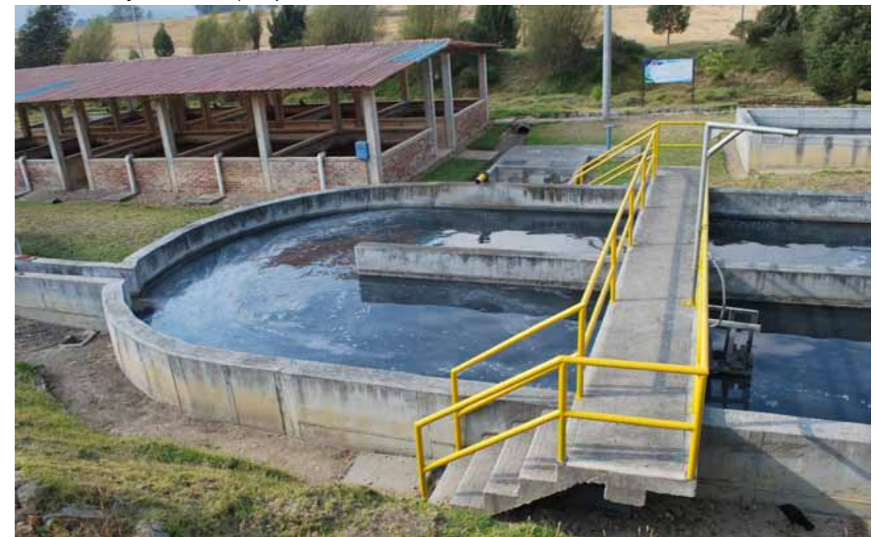
Planta de Tratamiento de Aguas Residuales del municipio de Bojacá.
