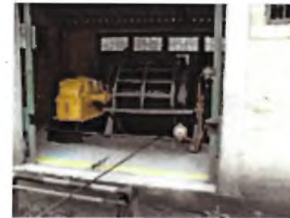
Malacate eléctrico con infraestructura que permite la contención de aceite, evitando la contaminación del suelo, Mina la Chisgua, Municipio de Sutatausa.
