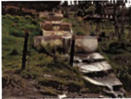
Sistema de tratamiento de aguas provenientes de la explotación minera, Ahismar, Municipio de Sutatausa.
