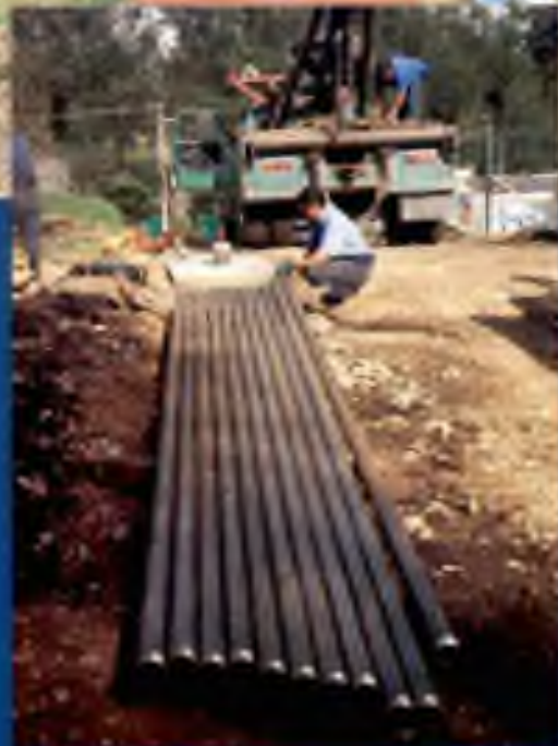
Tubería de descarga para suministro
