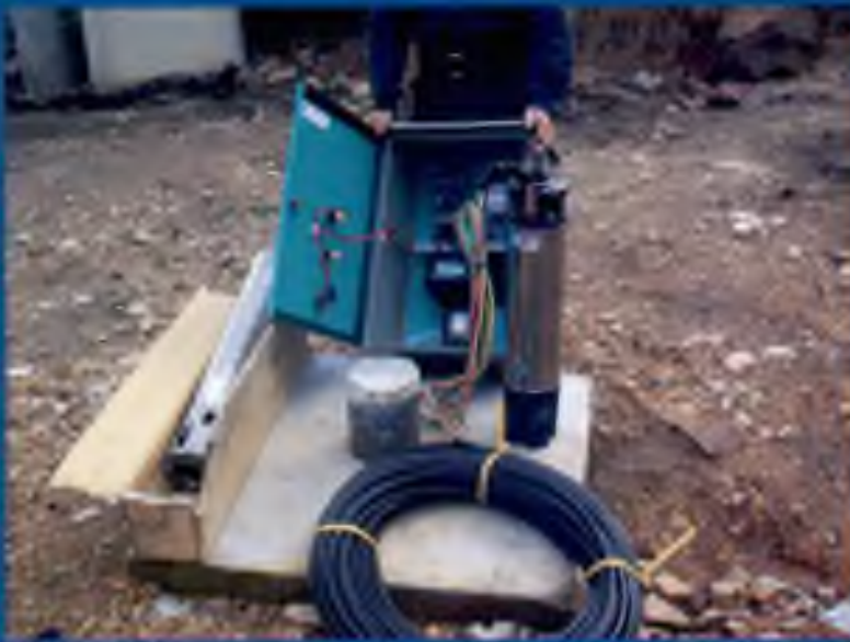
Sistema eléctrico para equipo de extracción
